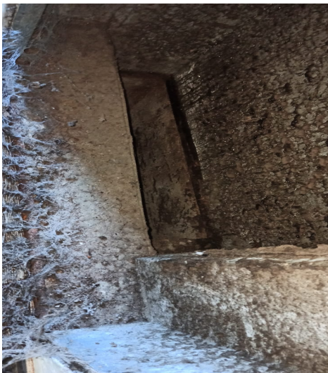
Toma retorno en comedor, ducto de hormigón
